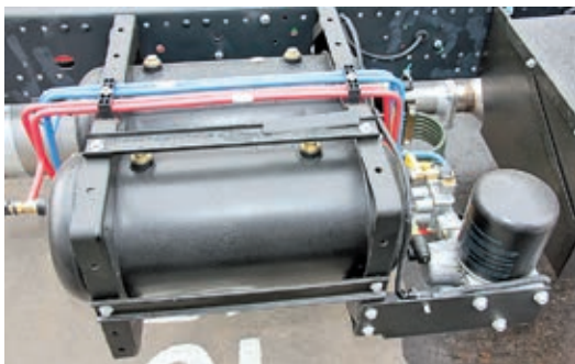
Цветные трубопроводы пневмосистемы аккуратно выполнены из нейлоновых труб
